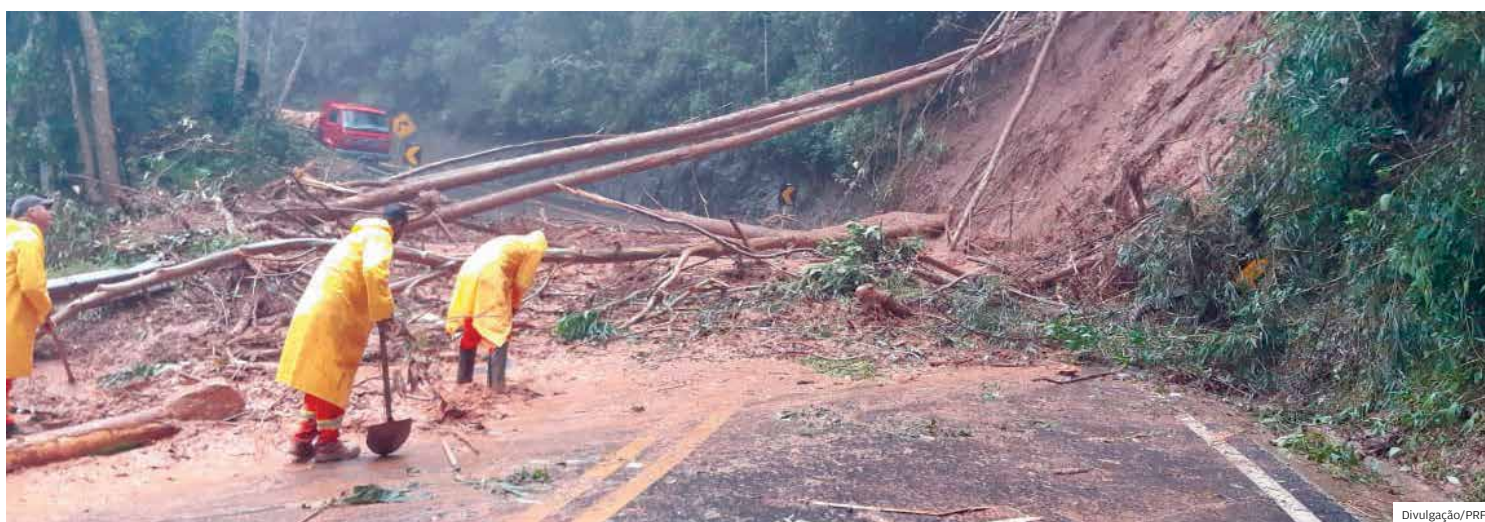
Chuvas. A Rodovia BR-459, que liga o Vale do Paraíba ao sul de Minas Gerais, precisou ser totalmente interditada nesta terça-feira após uma barreira cair nas duas pistas. O caso ocorreu após o registro de um grande volume de chuvas na altura do km 9, no trecho de Piquete.
