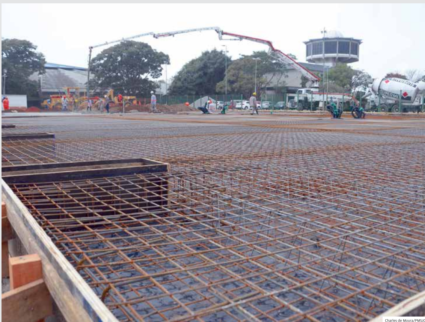
Saúde. Concretagem da base do Hospital de Retaguarda de São José dos Campos, que tem previsão de entrar em operação em julho
